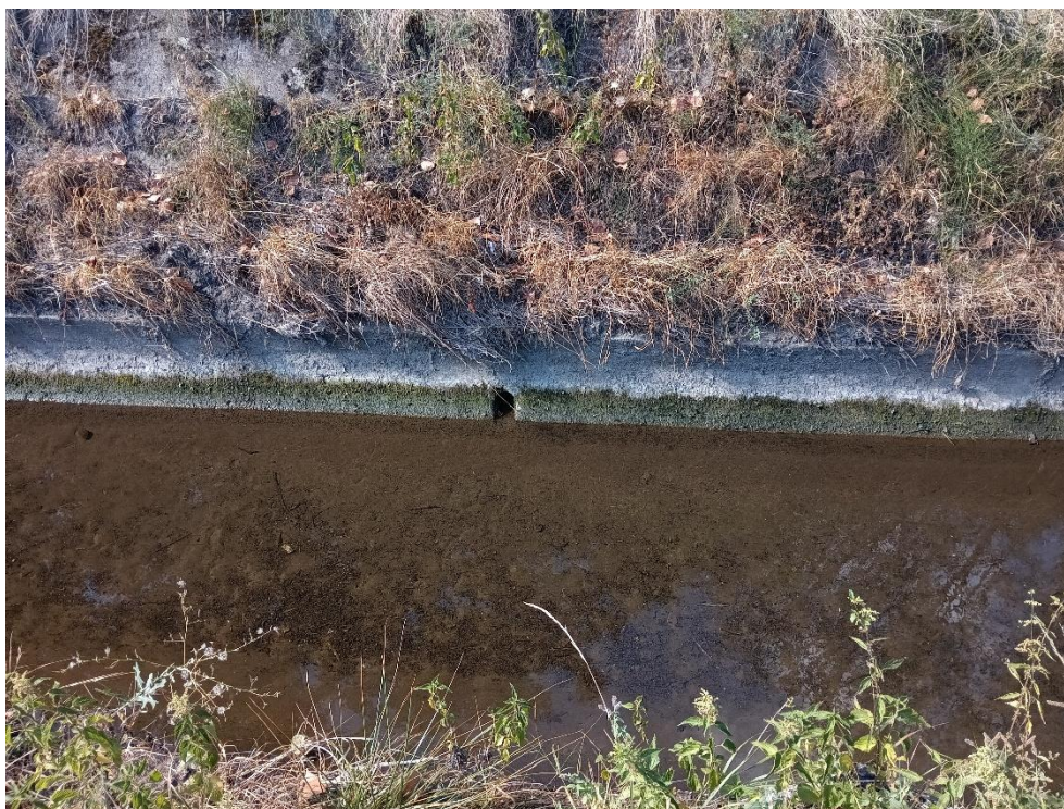
Fúrt áttörések a burkolatban feltehetően a nyomáskiegyenlítés érdekében.
