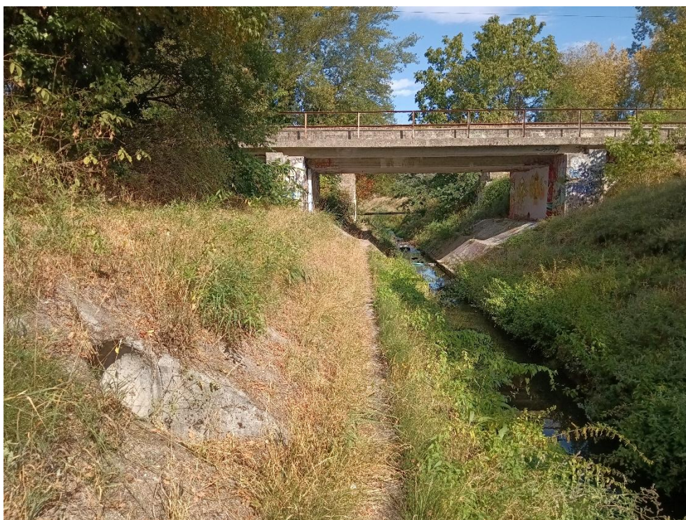
Nagyméretű csapadék-csatorna befolyónyílás a vereasegyházi vasútvonali híd előtt.
