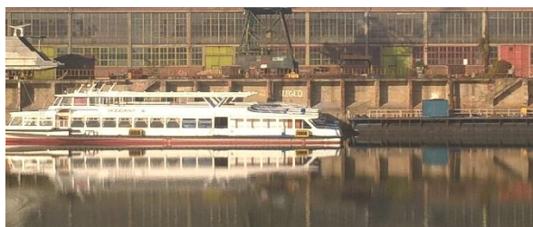
Rossz műszaki állapotú támfalak
