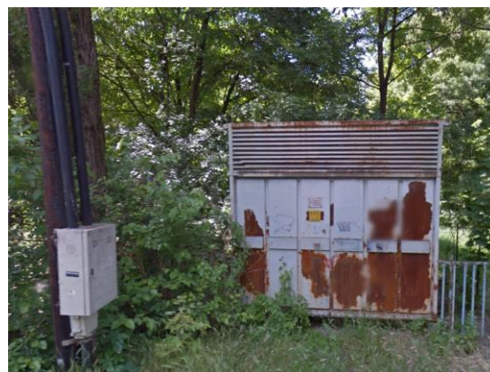
4103-as sz. lemezházas 10/0,4 kV-os transzformátor
