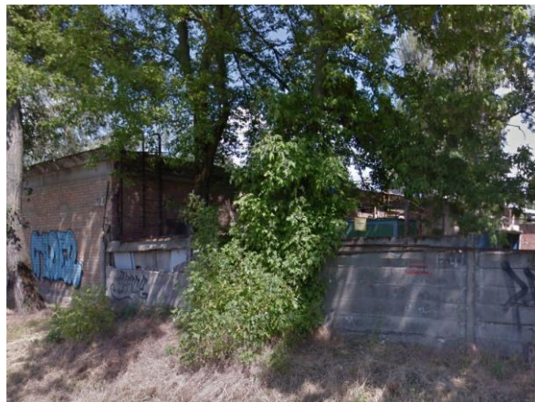
Népsziget úti gáznyomásszabályzó
