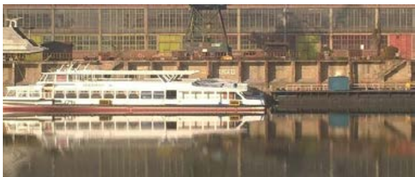
Rossz műszaki állapotú támfalak
