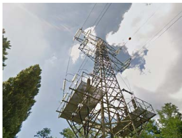
ELMŰ 120 kV-os légvezetékű hálózat kábelfejes oszlopa
