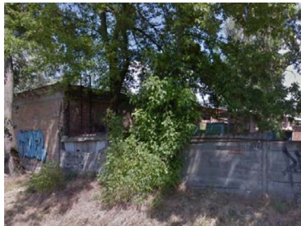
Népsziget úti gáznyomásszabályzó
