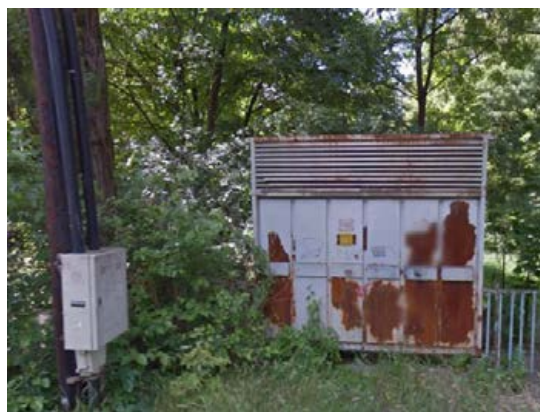
4103-as sz. lemezházas 10/0,4 kV-os transzformátor
