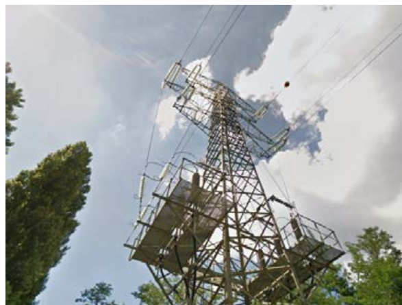
ELMŰ 120 kV-os légvezetékű hálózat kábelfejes oszlopa
