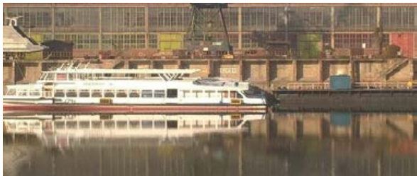
Rossz műszaki állapotú támfalak
