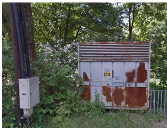
4103-as sz. lemezházas 10/0,4 kV-os transzformátor
