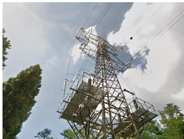
ELMŰ 120 kV-os légvezeték hálózat kábelfejes oszlopa
