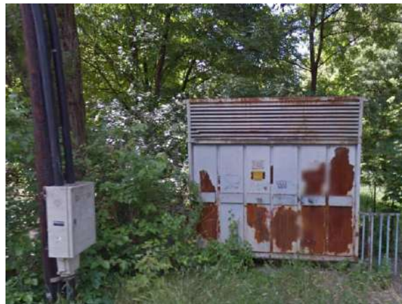
4103-as sz. lemezházás 10/0,4 kV-os transzformátor
