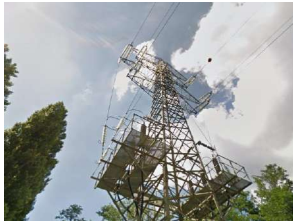
ELMŰ 120 kV-os légvezeték hálózat kábelfejes oszlopa
