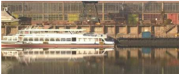
Rossz műszaki állapotú támfalak
