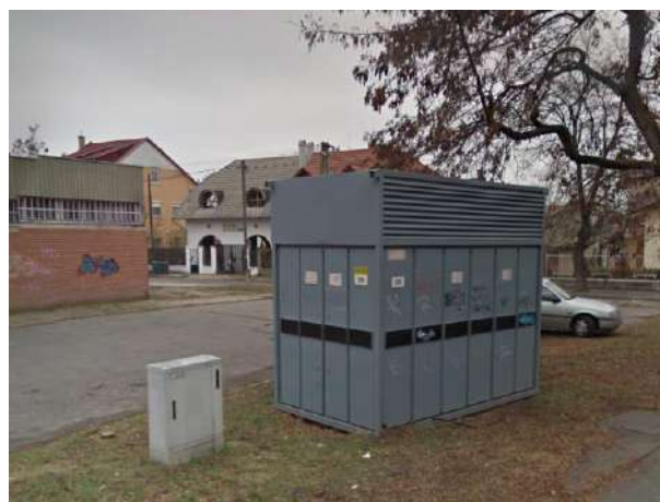
5099 sz. lemez házas 10/0,4 kV-os transzformátor, Béke tér
