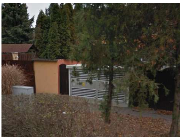
3607 sz. betonházas 10/0,4 kV-os transzformátor, Szabolcska M. u.
