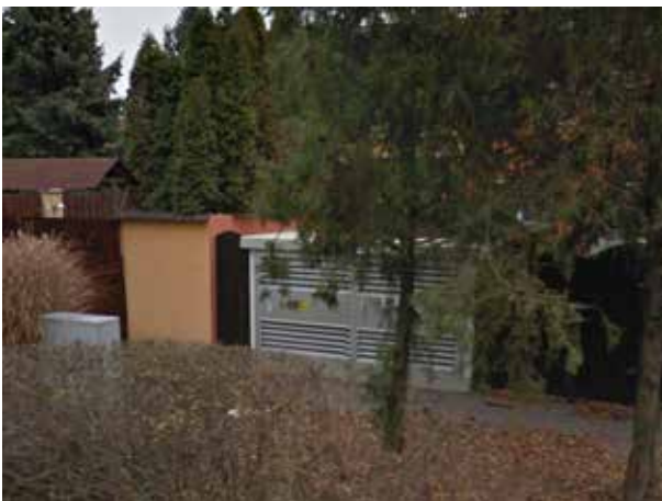
3607 sz. betonházas 10/0,4 kV-os transzformátor, Szabolcska M. u.
