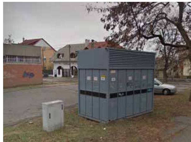
5099 sz. lemez házas 10/0,4 kV-os transzformátor, Béke tér
