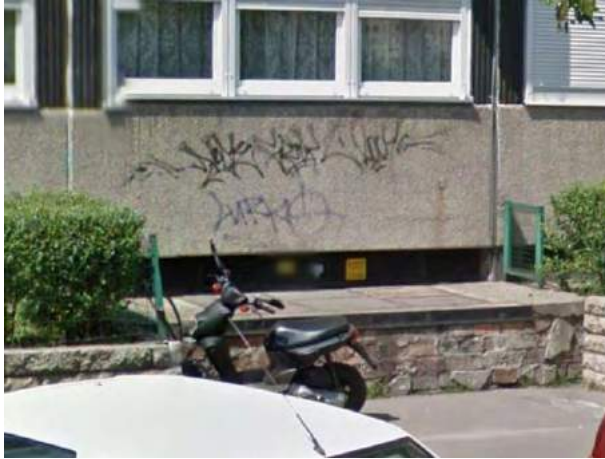
3399 sz. épületben elhelyezett 10/0,4 kV-os transzformátor, Rózsa utca
