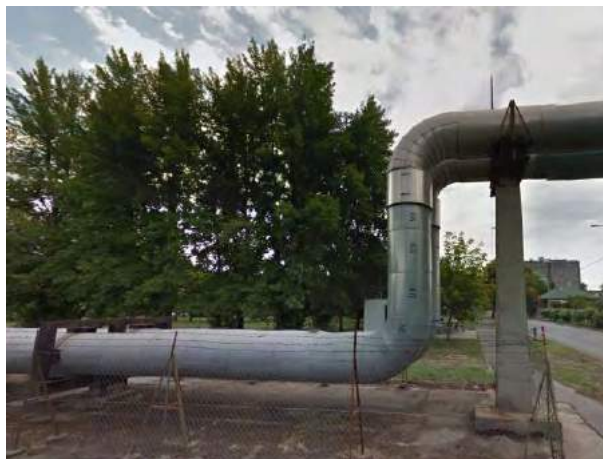
Fv 2 DN 600 magasvezetésű távhővezeték az Elem utcában
