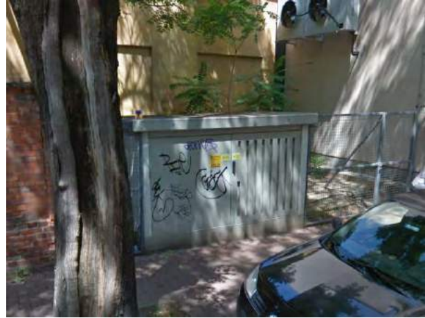
5139 sz. betonházas 10/0,4 kV-os transzformátor, József Attila utca
