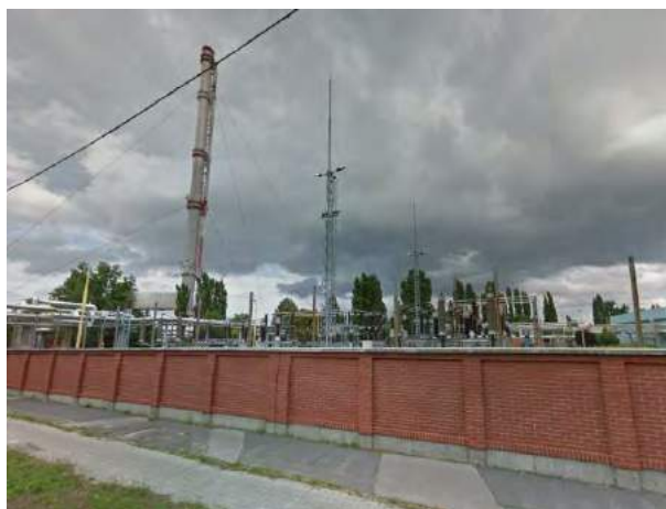
120 kV-os kapcsolóberendezések, Berliini utca
