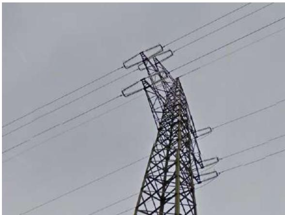
120 kV-os légvezeték rácsos tartóoszlopon a Balszam utcában
