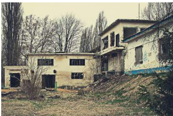
Tungsram strand leromlott állapotú épületei
